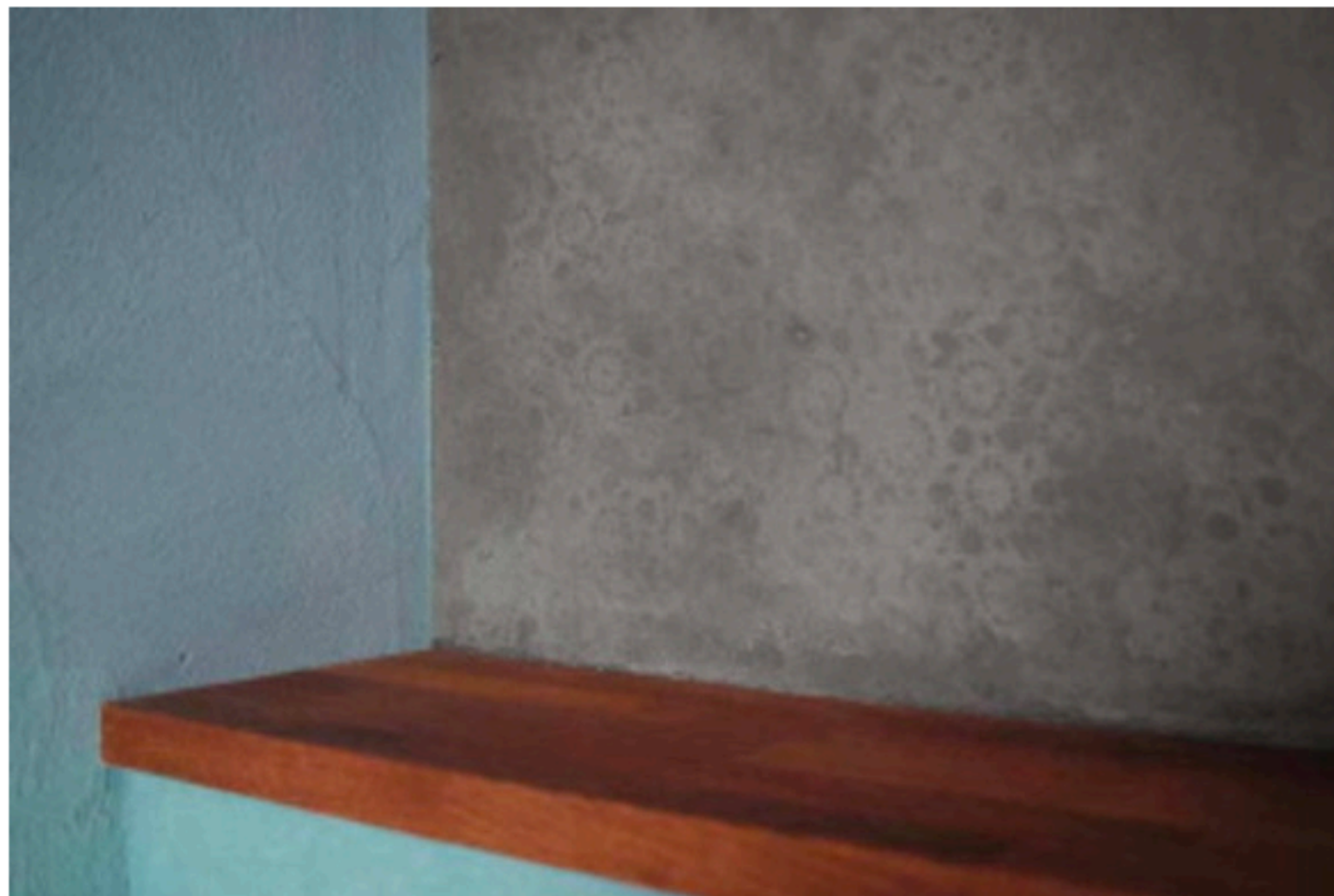
Ein Zementputz mit Häckelspitzen-Spuren.
